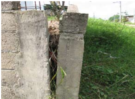
Ruptura de muro, el cual hace esquina en la manzana 25. Fotografía de Rubén Galicia.
