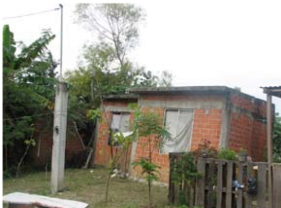
Casa dañada. Fotografía de Rubén Galicia.
