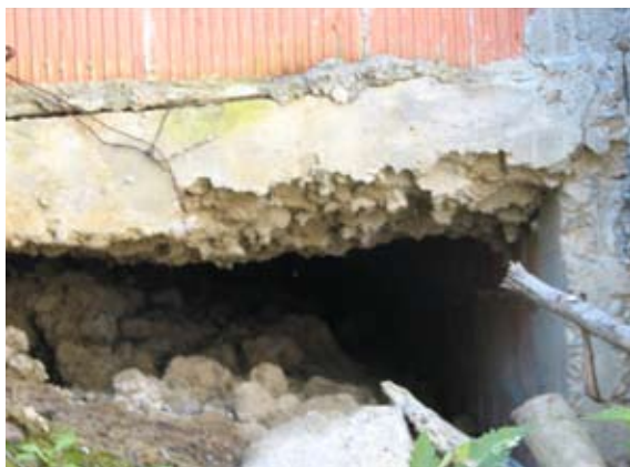
Pérdida de tierra que soporta la vivienda. Fotografía de Rubén Galicia.
