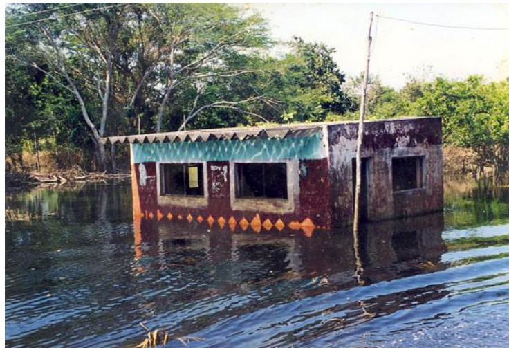
Foto 7. Escuela afectada en El Escondido
